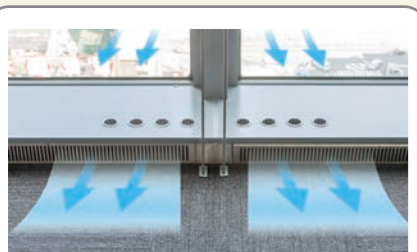
基準階窓廻りに電動式の自然換気口を設置。 オフィス内に自然外気を取り入れる事が可能。
