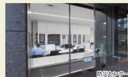
防災センター
