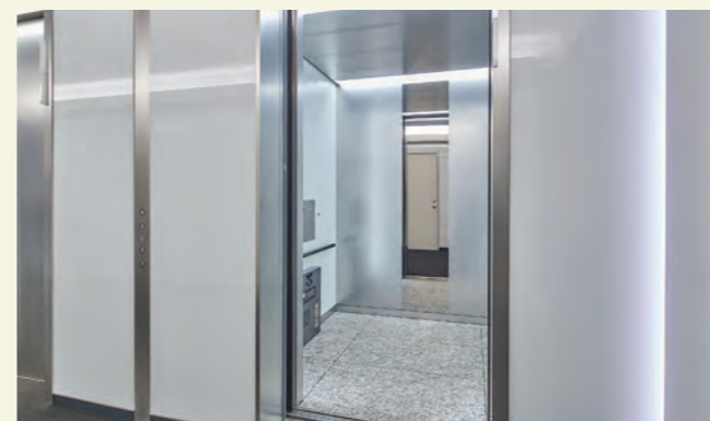
エレベーター
