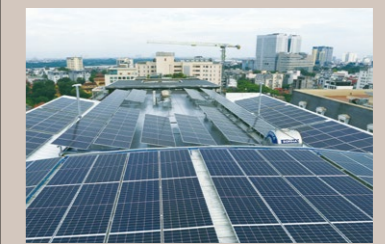
「コーナーストーン・ビルディング」の屋上に設置されたソーラーパネル
