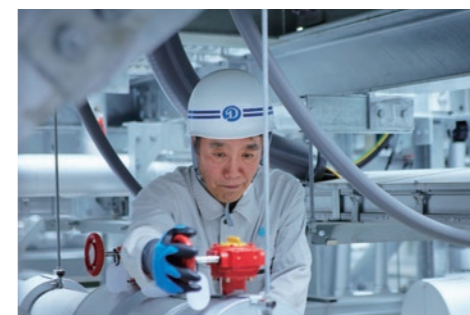
設備 テナント様が安心して過ごしていただけるように、ビルの電気・機械設備等の管理を徹底しています
